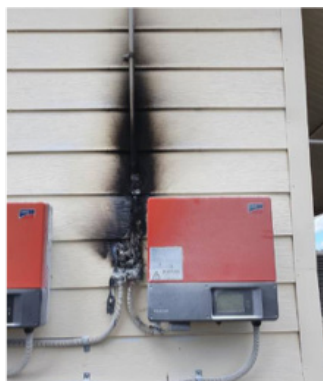
Slika 14: Oštećen invertor usled pregrevanja
