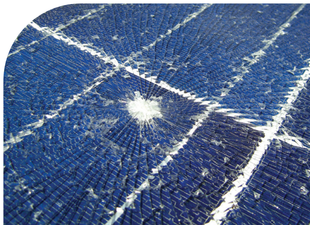
Slika 11: Oštećen fotonaponski panel
