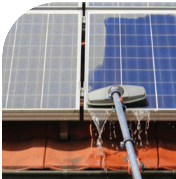
Slika 13: Čišćenje fotonaponskih panela
