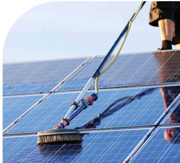
Slika 12: Čišćenje fotonaponskih panela
