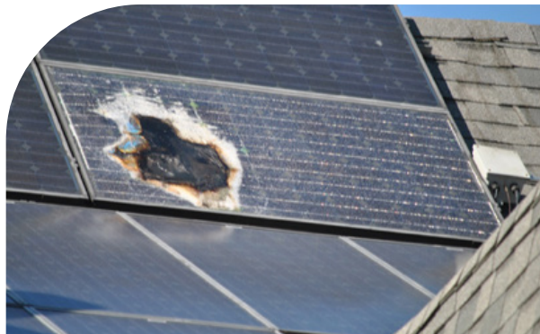
Slika 13: Oštećen fotonaponski panel
