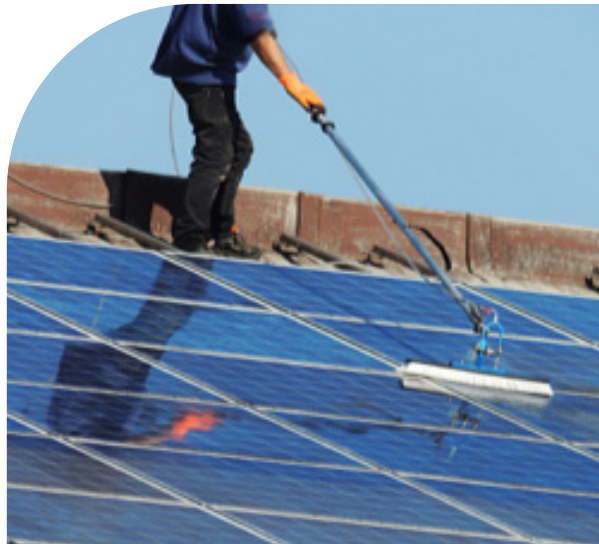
Slika 13: Čišćenje fotonaponskih panela
