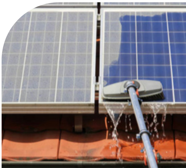
Slika 14: Čišćenje fotonaponskih panela
