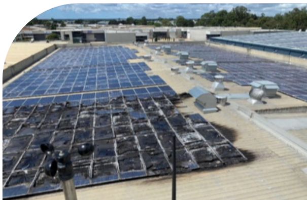
Slika 12: Oštećen fotonaponski panel
