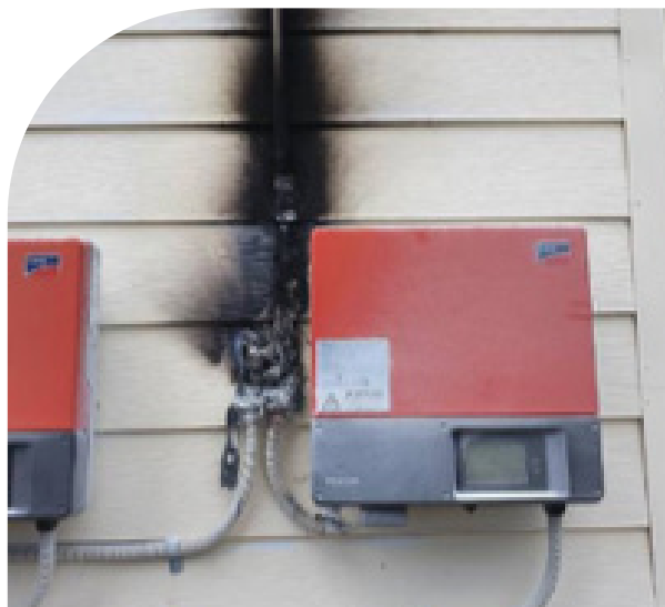
Slika 15: Oštećen inverter usled pregrevanja
