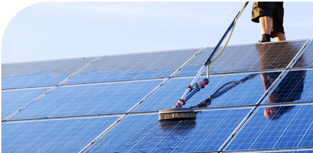
Slika 13: Čišćenje fotonaponskih panela
