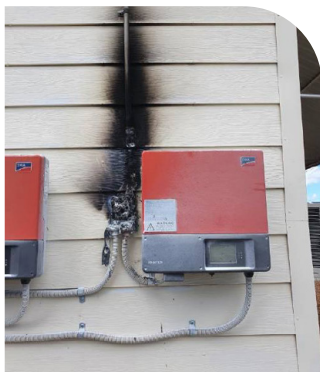
Slika 14: Oštećen inverter usled pregrevanja
